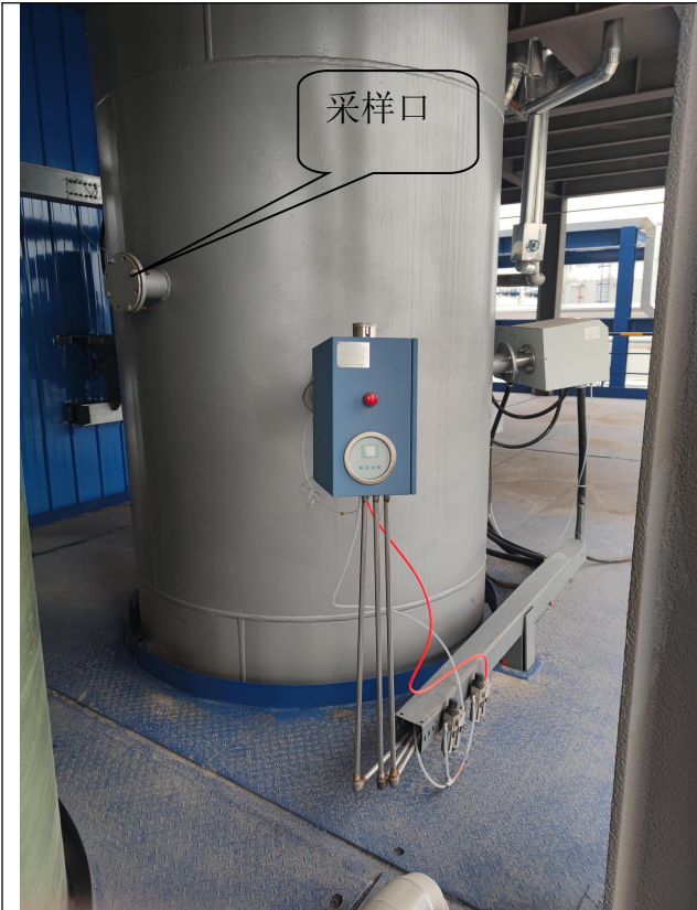
焚烧炉排气筒采样平台及采样口
