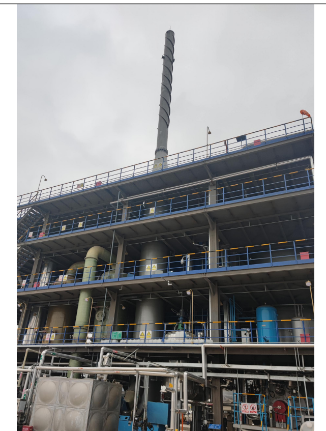
焚烧炉排气筒
