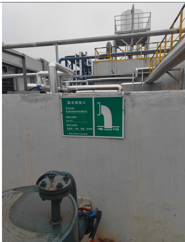
废水排放口标识
