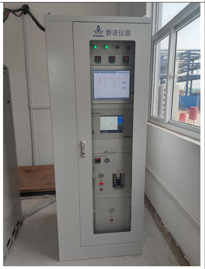
焚烧炉排气筒 VOCs 自动检测设备
