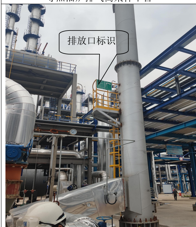
导热油炉排气筒标识
