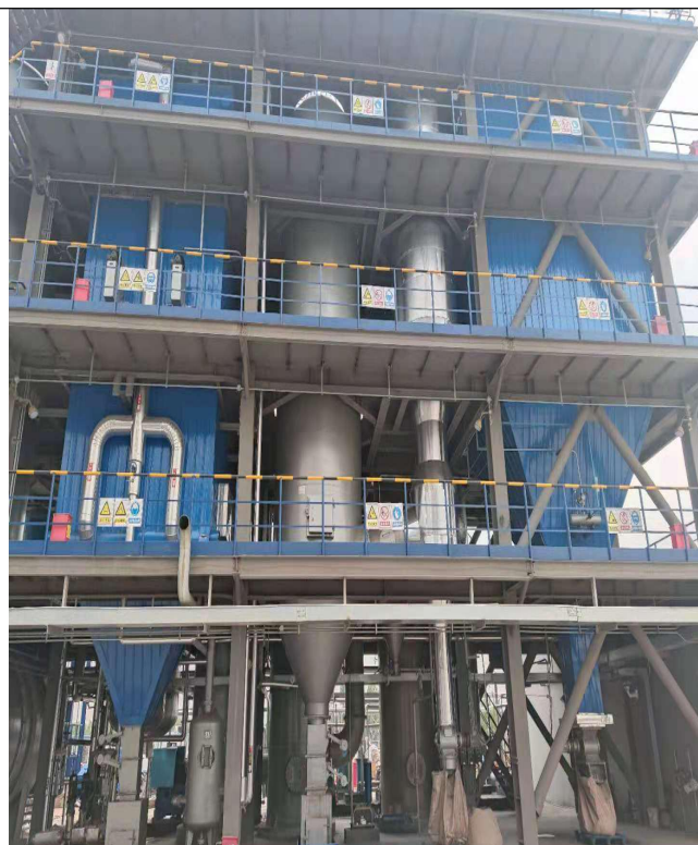
半干急冷塔+干式吸收塔+布袋除尘器
