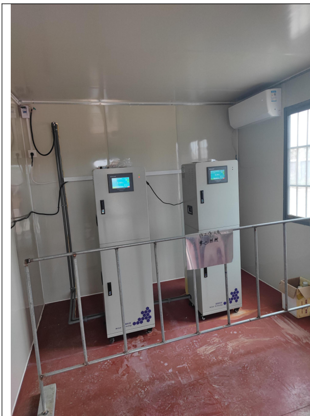
厂区废水自动监测设备
