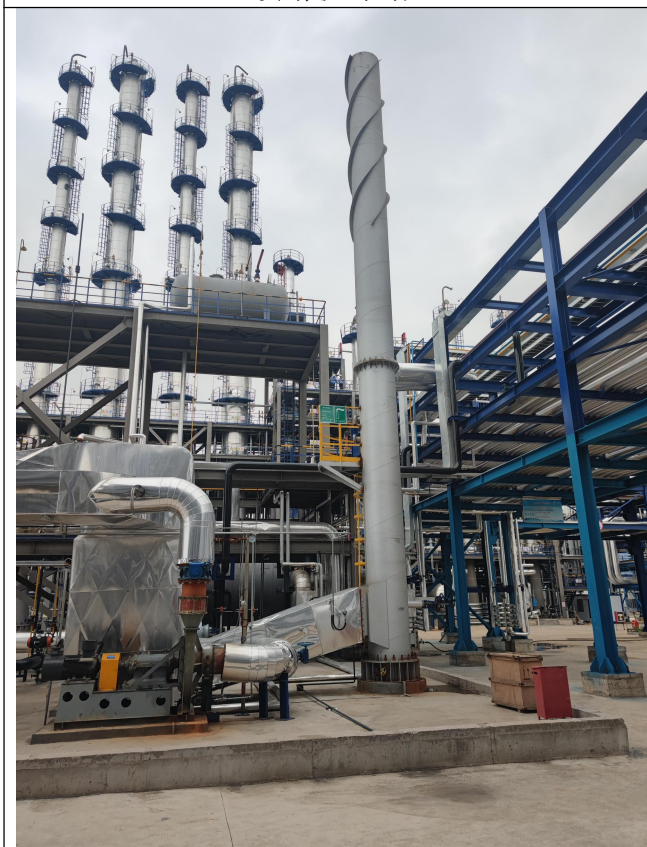
导热油炉排气筒
