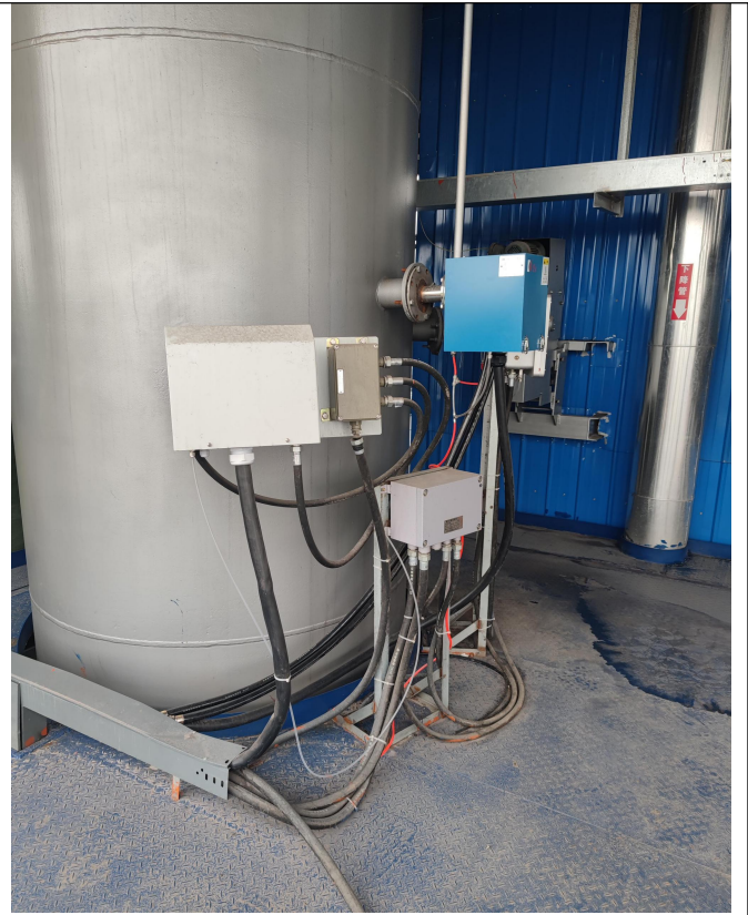
焚烧炉排气筒自动检测设备采样口
