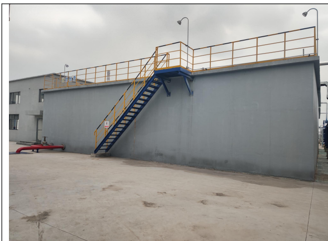
消防泵房及水池
