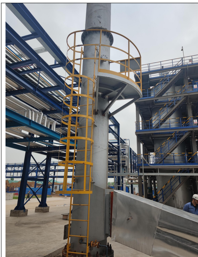
导热油炉排气筒采样平台
